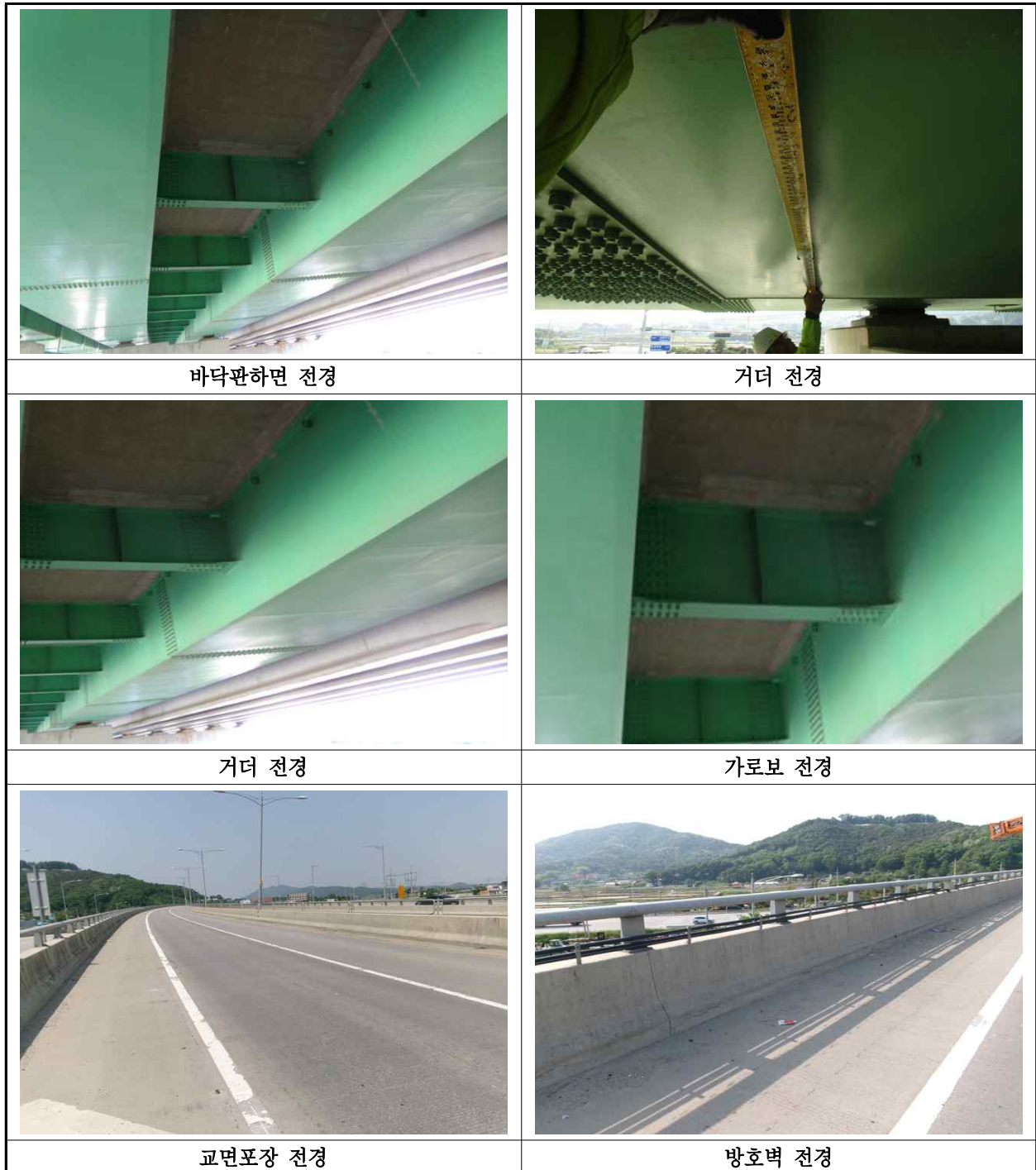
【사진 1.2.2】 상부구조 현황
